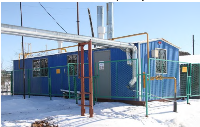
Рис.3. Внешний вид модульной котельной в дер.Кокошкино
