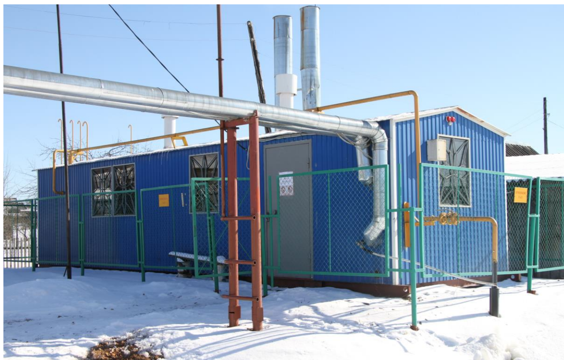
Рис.3. Внешний вид модульной котельной в дер. Кокошкино
